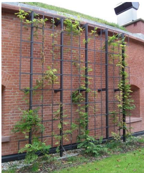
Ryc. 38. Konstrukcje dla pnączy na elewacjach.
